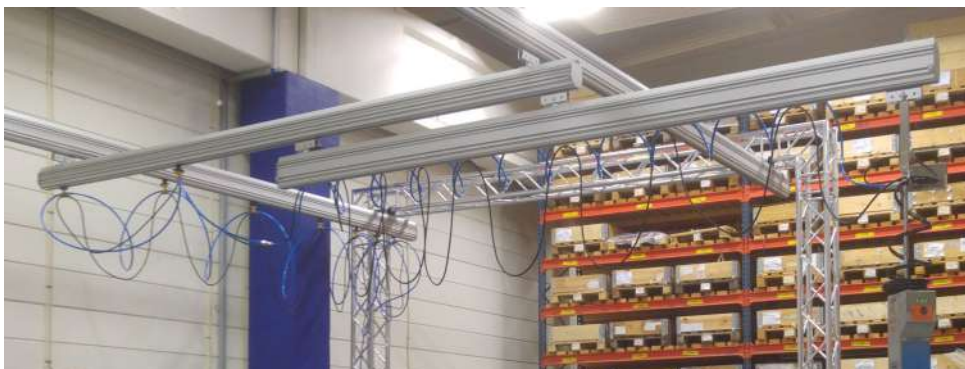
Exempel på teleskoptravers, där då den undre traversbalken går ut utanför det ordinarie arbetsområdet.
